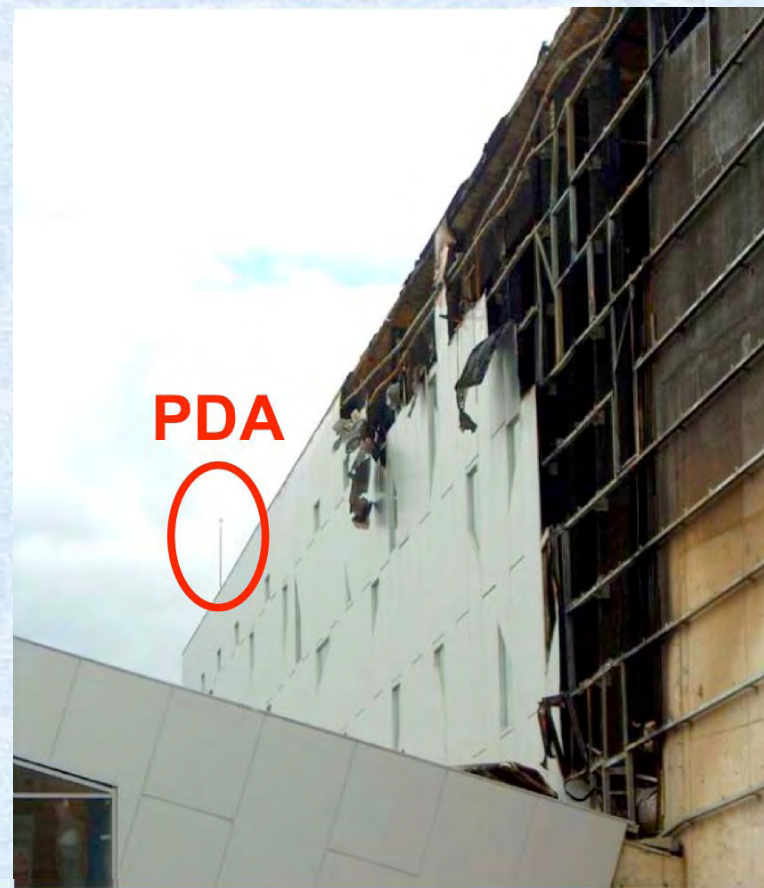
Gymnase d'Alcobondas, foudroyé le 8 octobre 2005
