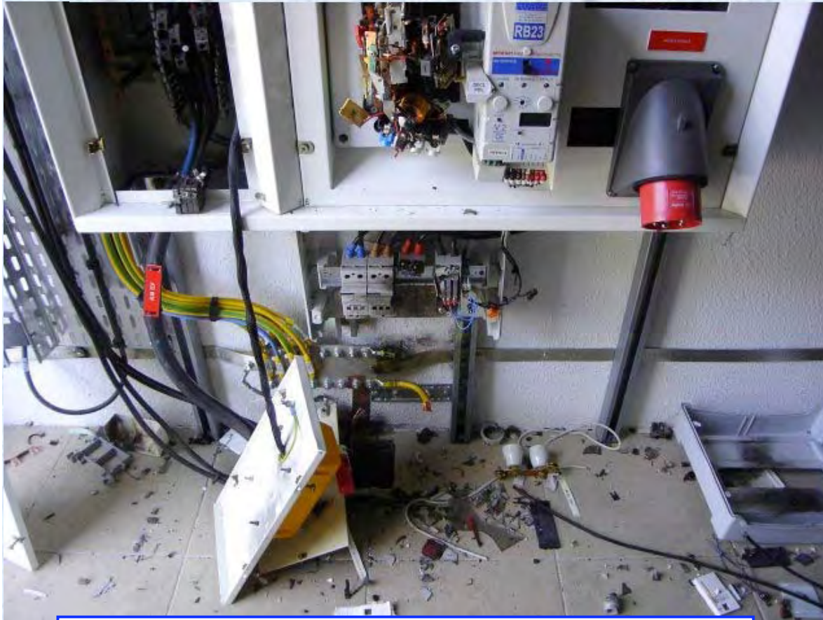
Les effets d'un coup sur un pylône...
