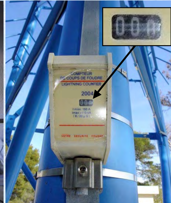
Son compteur après le choc (conforme à l'UTE C 17-106)
